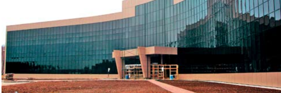
Фасады завершения строительства фармацевтической фабрики с применением сборно-монолитного каркаса с шагом колонн 12 м и высотой этажа до 7,2 м в п. Вольгинский Владимирской области, ООО «Пикс», ООО «Карнас-НН», группа компаний «Рекон-СМК», 2010 г.
