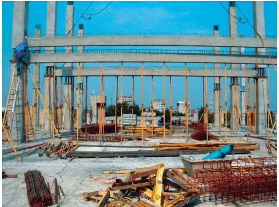
Монтаж преднапряженных балок l=15 м на строительстве 5-этажного здания с применением сборно-монолитного каркаса с пустотным настилом, ООО «Каркас-Ч», г. Чебоксары
