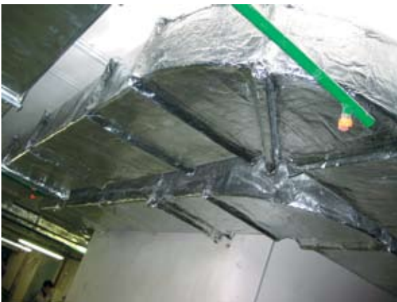
Огнезащита воздуховодов ET VENT производства ОАО «ТИЗОЛ» после 5 лет эксплуатации
