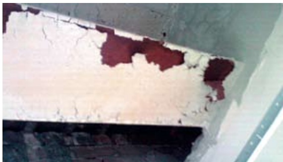
Краска для огнезащиты металлоконструкций после 1,5 лет эксплуатации
