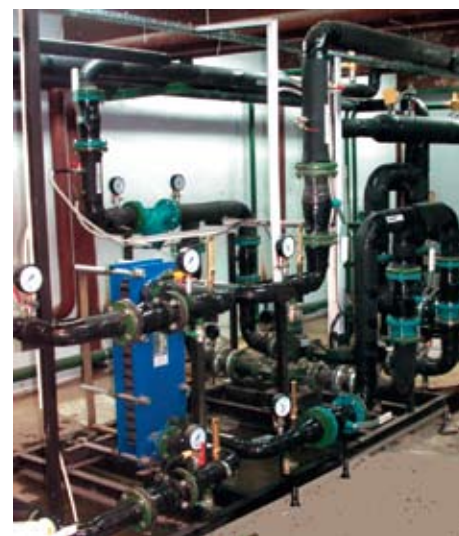
Индивидуальный тепловой пункт
