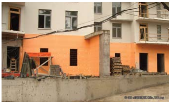
Рис. 1. Примеры явных разрушений конструкции цокольной части здания
