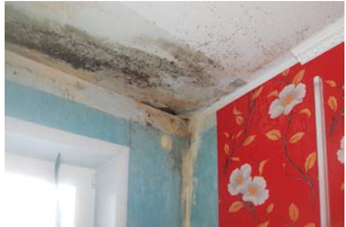
Рис. 2. Последствия попадания влаги в толщу фасада, распространение поражения внутри здания из-за нарушения вентиляции и влажности
