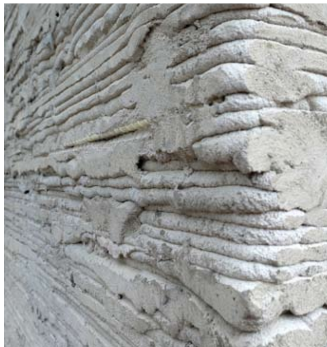
Рис. 10. Пример стены, напечатанной с помощью строительного 3D-принтера, где смесь не соответствует требованиям (слои раздавливаются и расплываются)
